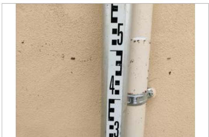
Trace sur la gouttière
