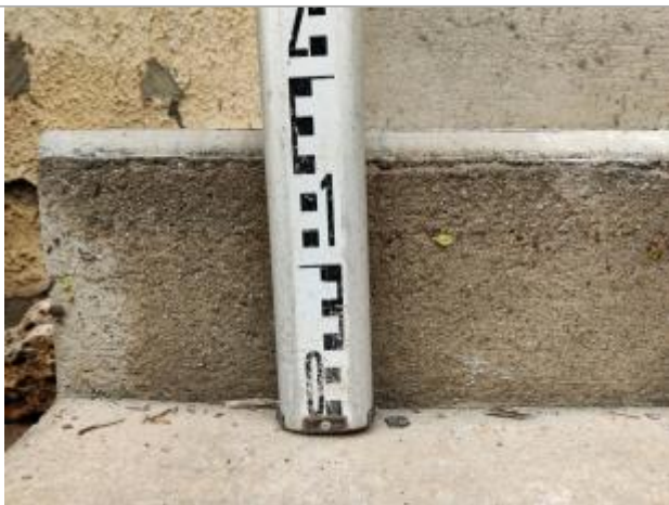
Trace sur les escaliers
