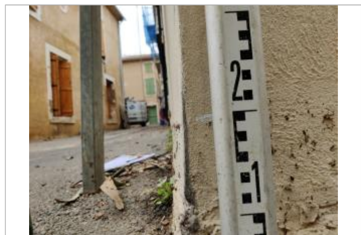
Trace sur le mur
