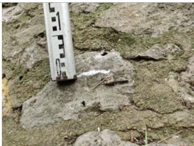
Trace sur le mur
