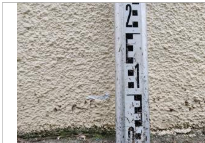
Trace sur le mur
