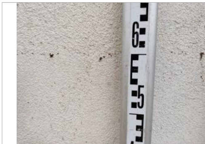
Trace sur le mur
