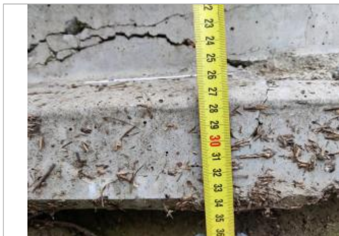
Trace sur la poutre
