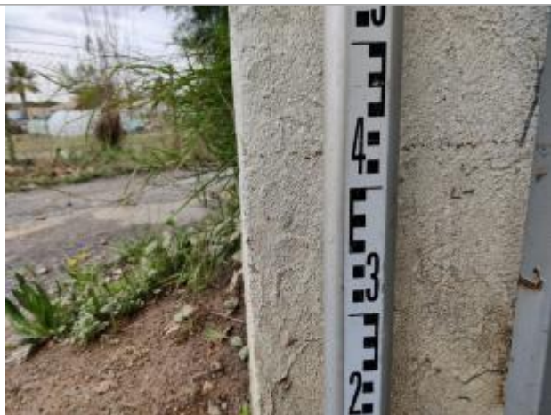
Trace sur le montant
