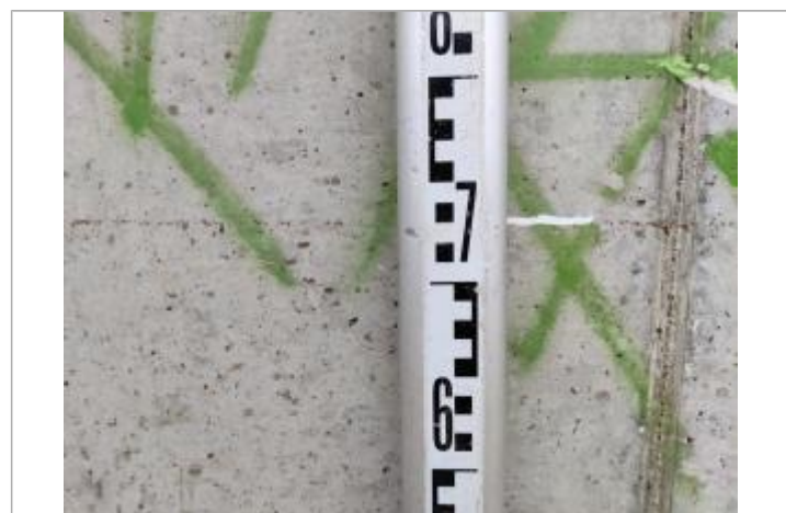
Trace sur le mur
