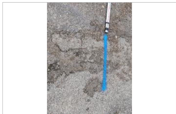
Dépôt au sol
