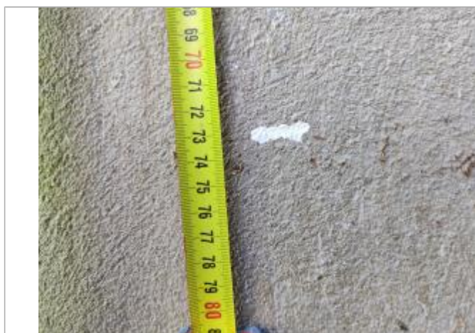
Trace sur le mur
