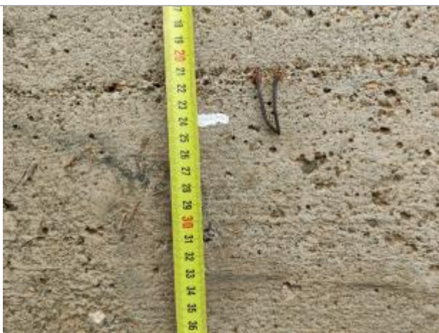
Trace sur la digue
