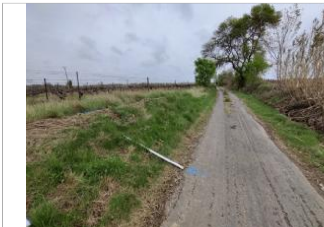
Talus en bord de chemin
