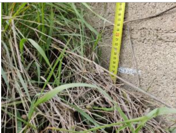
Trace sur la culée en parpaing
