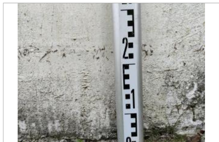
Trace sur le mur
