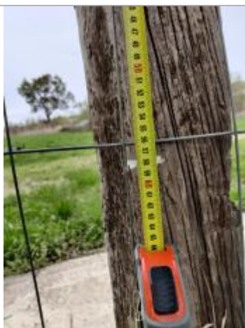
Trace sur le poteau
