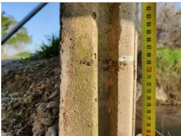
Trace sur le garde-corp
