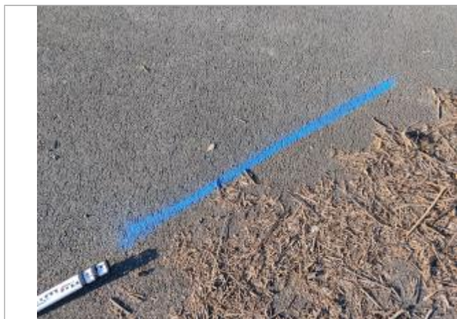
Dépôt sur la chaussée
