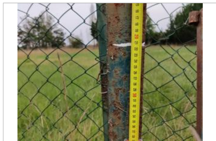
Trace sur le montant
