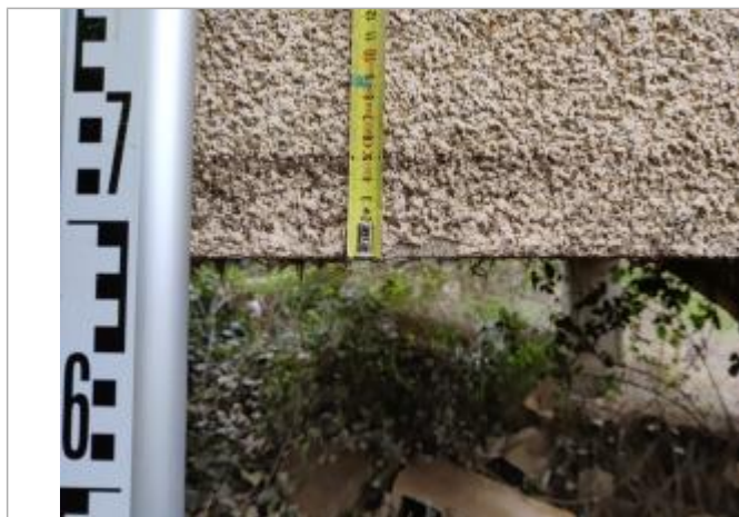
Trace sur le mur du transformateur
