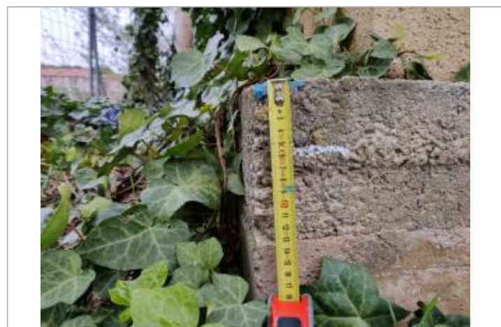
Trace sur les fondations du transformateur
