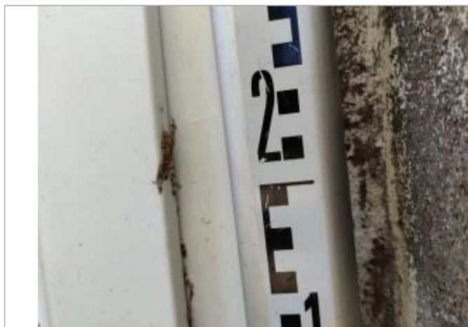
Trace sur le mur
