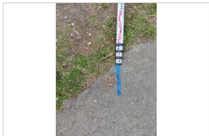
Dépôt sur la piste (débordement dans le canal)
