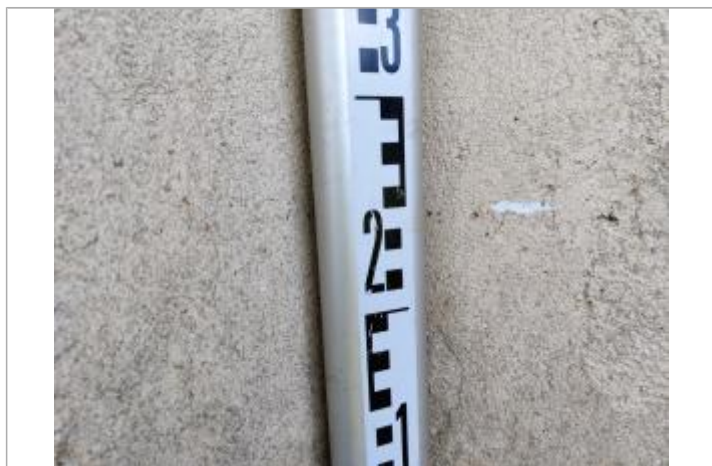
Trace sur le mur
