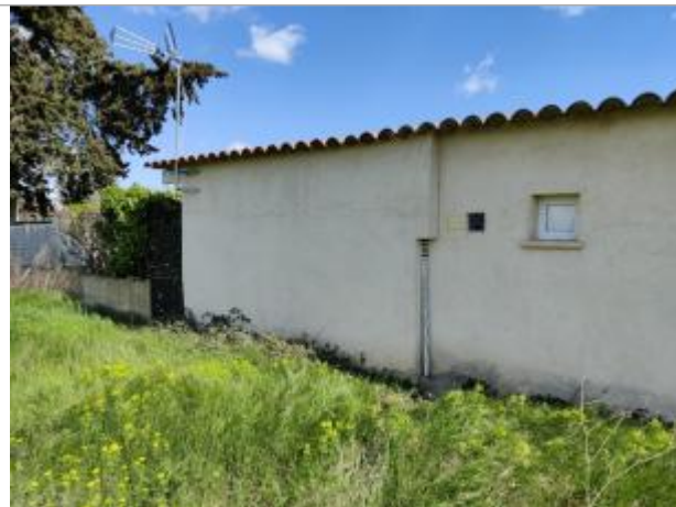
Mur de la maison
