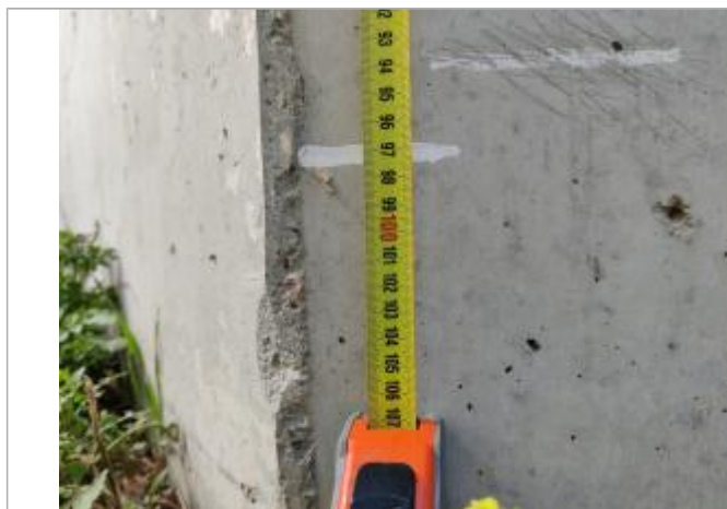
Trace sur la digue
