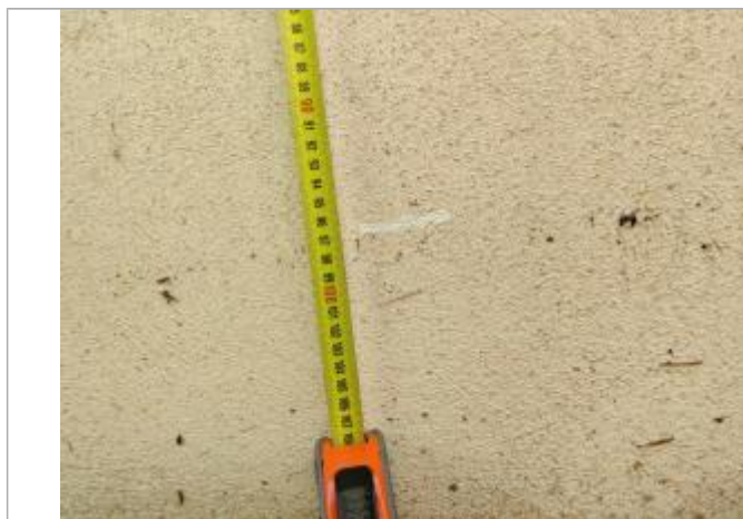
Trace sur le mur
