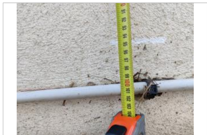
Trace sur le mur
