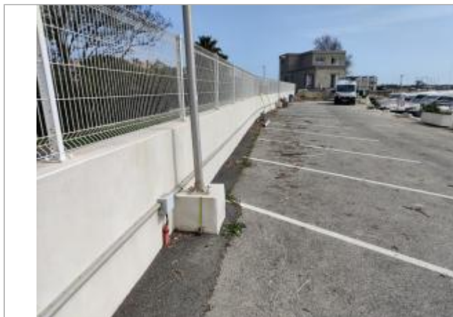
Massif béton de réverbère
