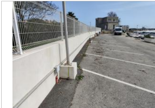
Massif béton de réverbère
