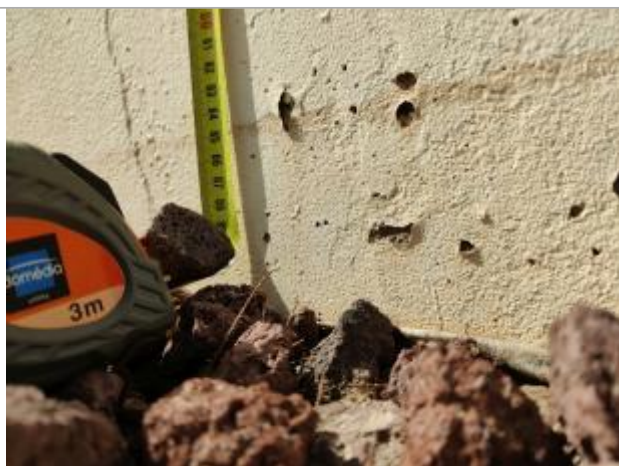
Trace sur le mur
