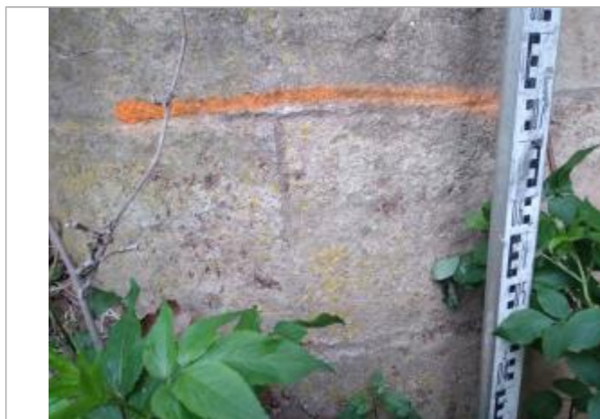
Trace sur le pile du pont
