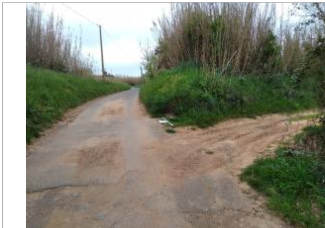
Talus en bord de chemin
