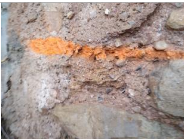
Trace sur le mur
