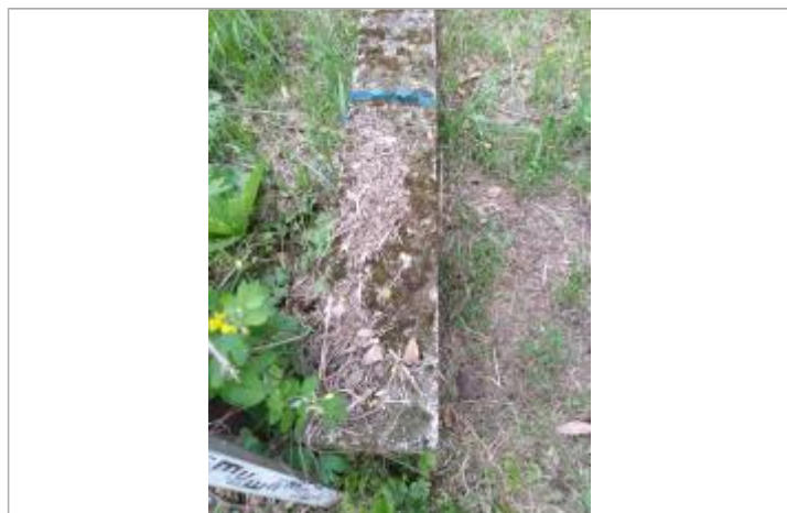
Dépôt sur le muret
