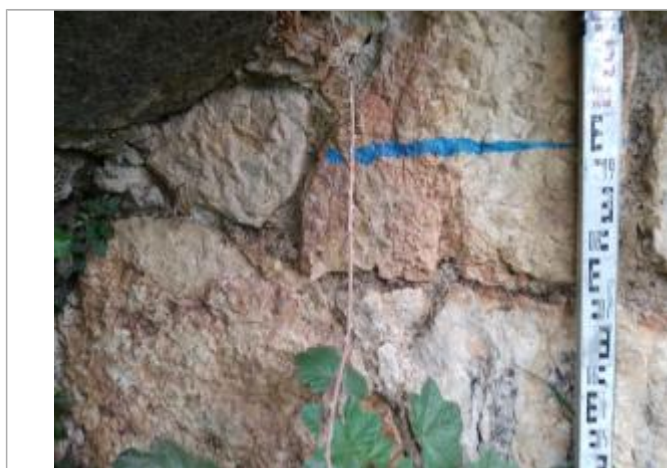
Trace sur le mur
