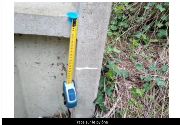
Trace sur le pylône
