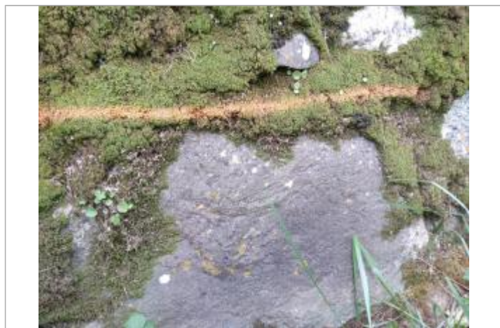
Trace sur le mur
