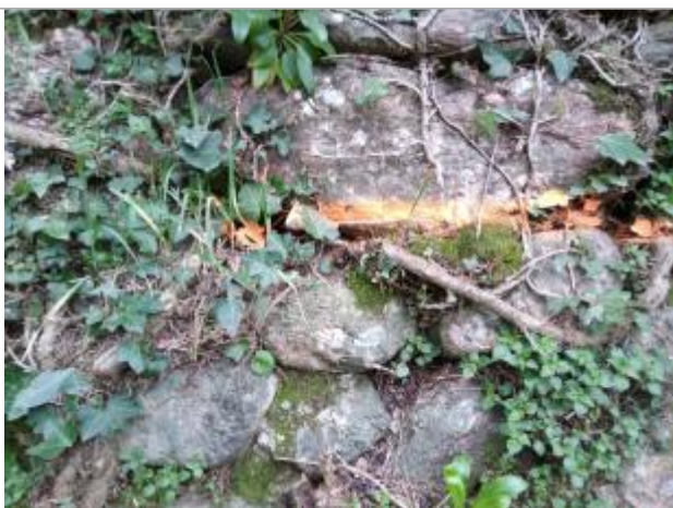
Trace sur le mur
