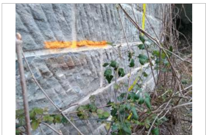
Trace sur la face aval
