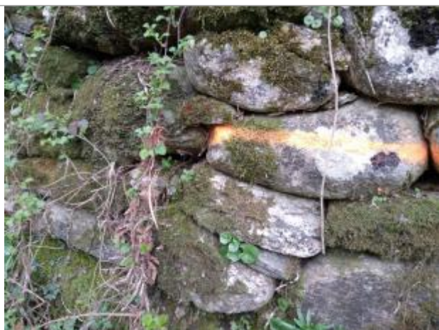
Trace sur le mur
