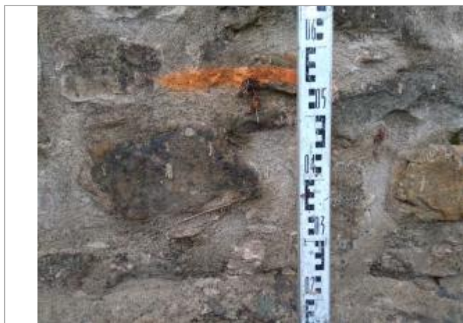
Trace sur la digue
