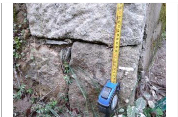
Trace sur le mur
