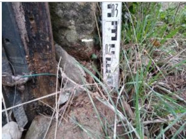
Trace sur le mur
