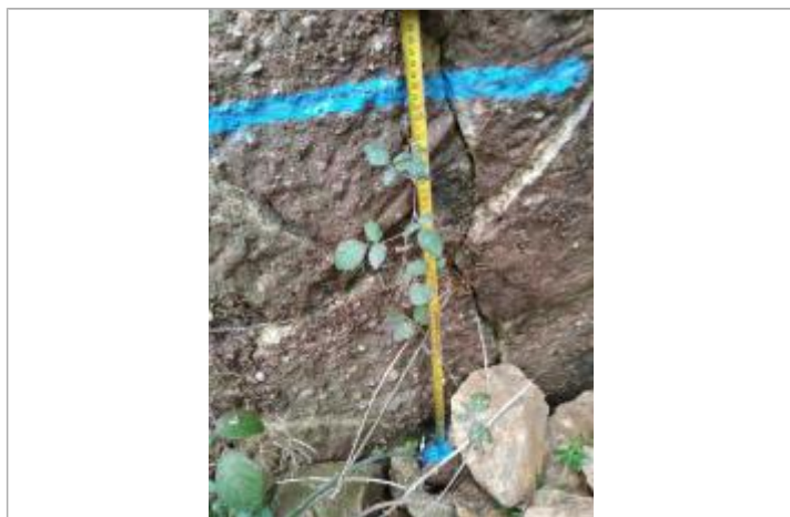
Trace sur la culée
