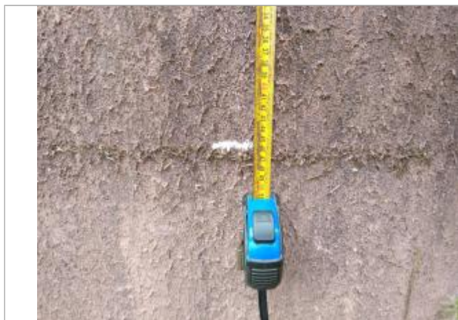
Trace sur le mur
