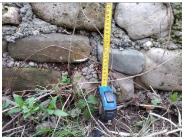
Trace sur le mur
