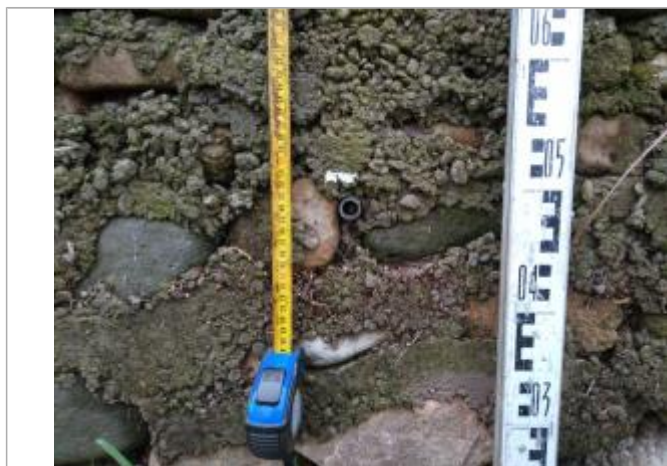
Trace sur le mur
