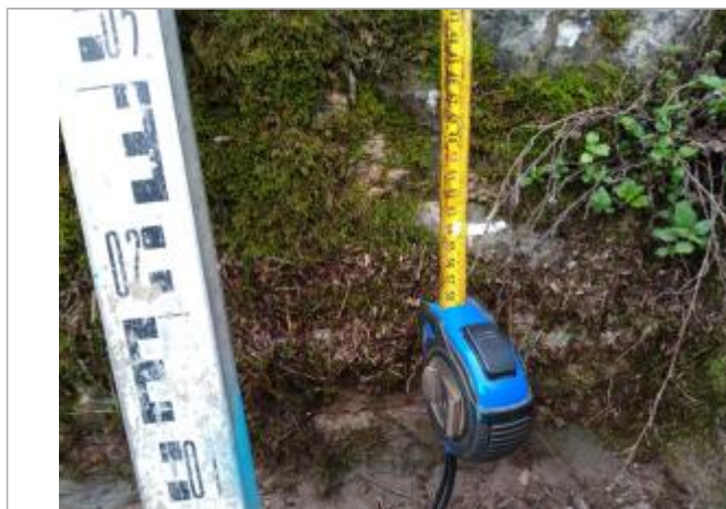
Trace sur le mur
