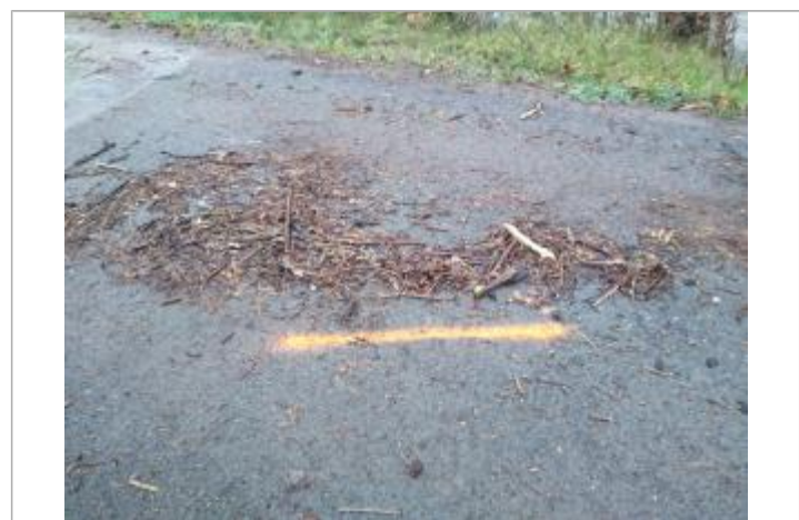
Dépôt sur la chaussée
