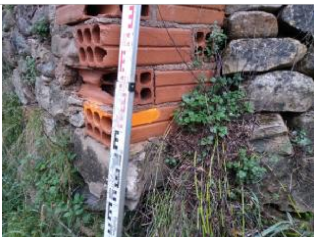
Débris végétaux accrochés au mur
