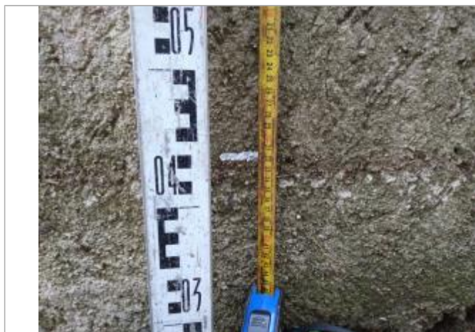
Trace sur le muret
